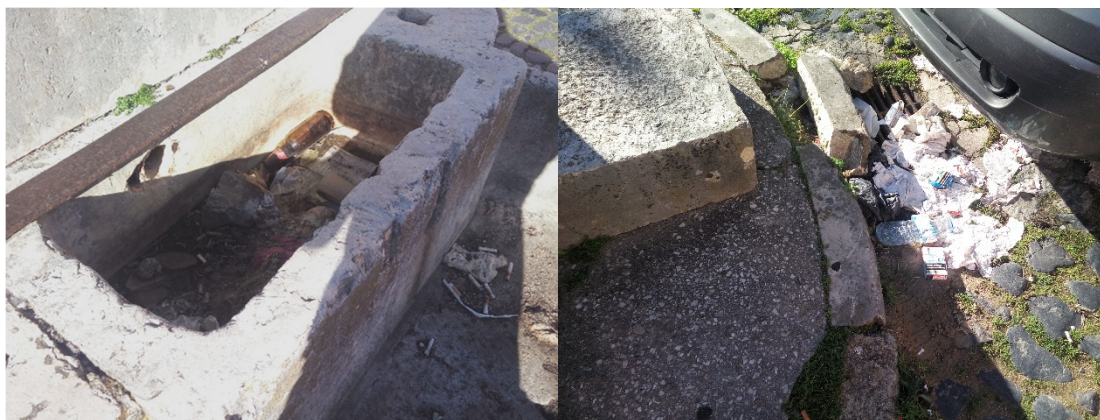
Figura 17. Estado de uma das pias usada como caixote do lixo e envolvente proximal do chafariz. Fonte: Fotografia privada, captada a 25 de Janeiro de 2019.
