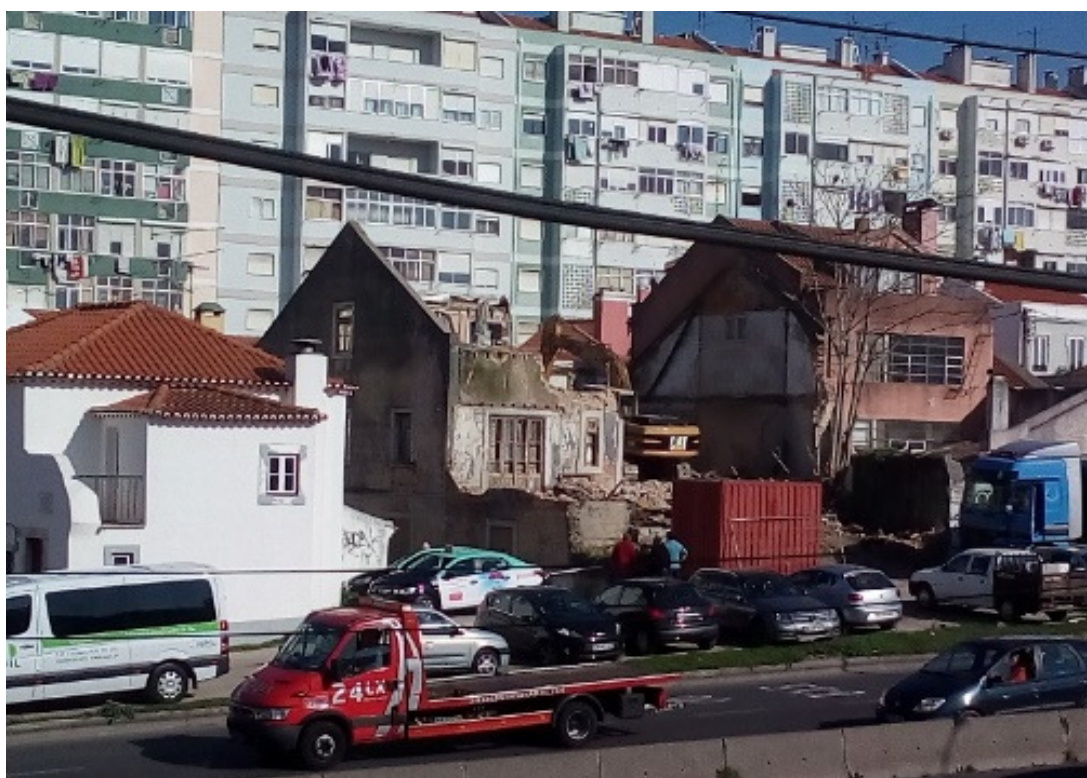
Figura 28. Aspecto da mais recente “vitima do tempo” na Rua do Lumiar. Nesta casa muito há para reconstruir e pouco para reabilitar. Reveja-se como era esta casa na Figura 26. Fonte: fotografia privada, 13 de Fevereiro de 2019.
