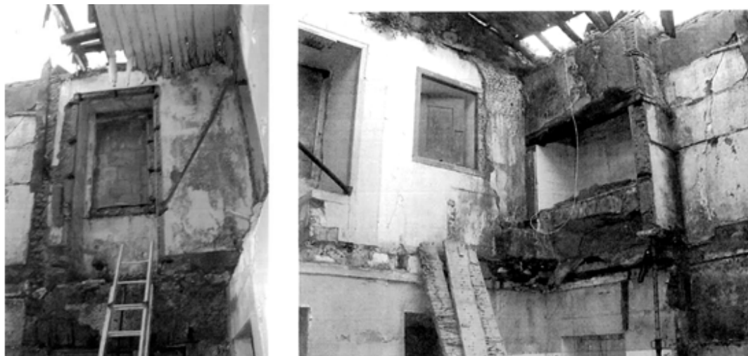
Figura 20. Aspectos parciais do estado interior da casa em 2013. Fonte:
