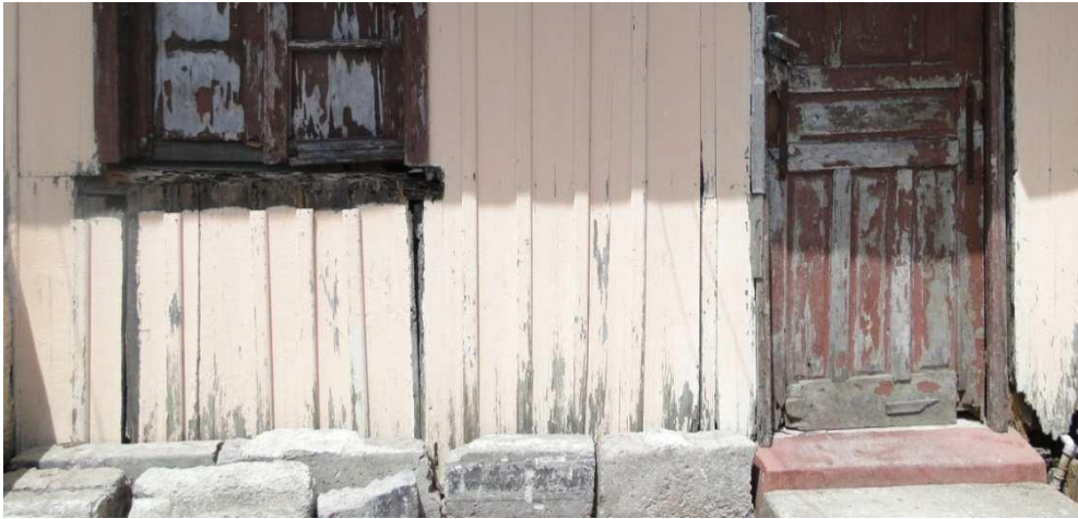
Figura 13. Deteriorações na fachada. Fonte: Freddy Bager Jr.
