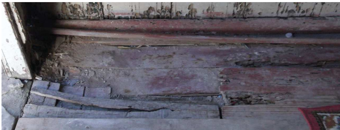
Figura 20. Piso interno. Detalhe para o dano. Fonte: Paulo Enéas.
