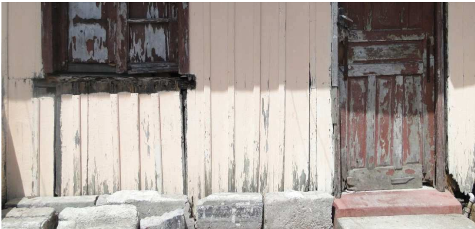
Figura 13. Deteriorações na fachada. Fonte: Freddy Bager Jr.
