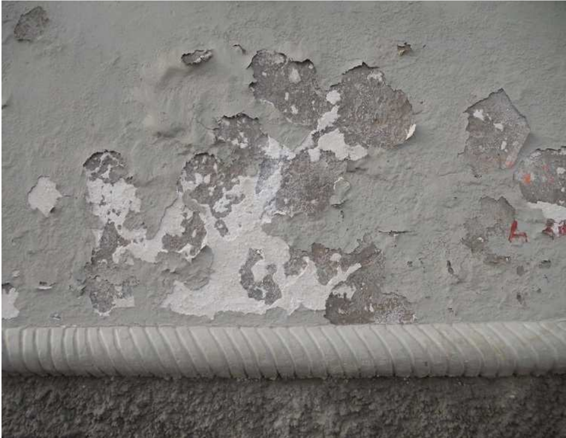
Figura 9. Degradação do revestimento após substituição do original por uma argamassa de cimento, Torre de Belém, Mindelo. Fonte: As Autoras
